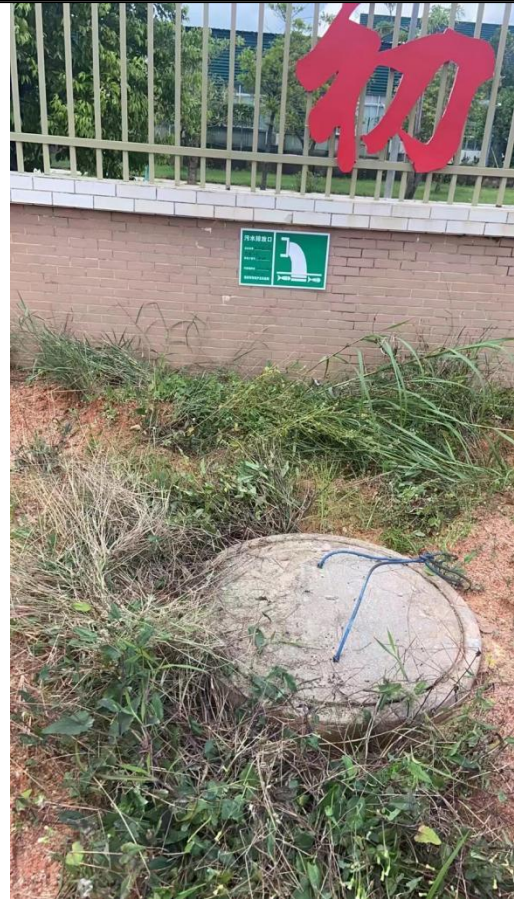
图 11 生产废水排放口规范图片（生产废水处理设备为地埋式）
