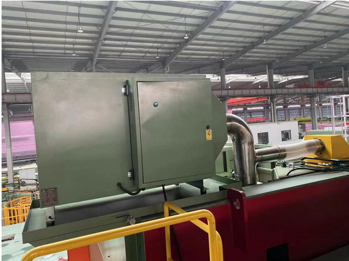
图 4-1 生产线配套静电除油回收装置
