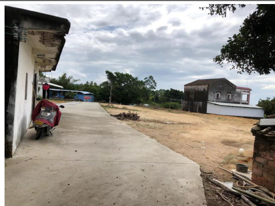
拟修复砵地坪道路现状
